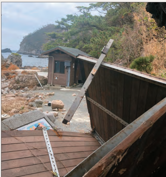
▲建築物が飛び、温泉への入口を塞いでしまっている
