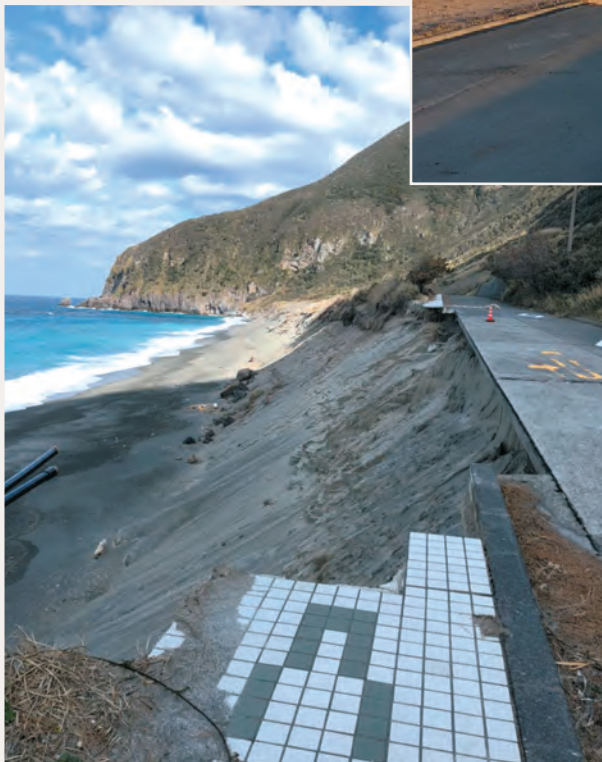
◀台風前から崩落で立入禁止となっていた和田浜海岸線は、廃道も含めて復旧方法を検討予定
