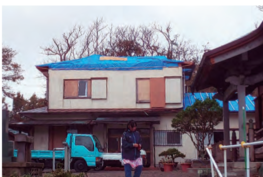
▲台風15号で被災した民家。村内の民家は被害の大小はあるが、ほとんどの民家が被災した。
