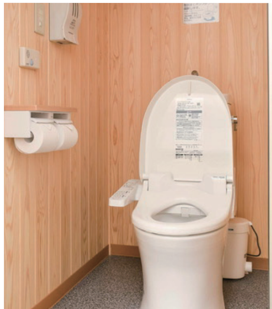
▲ソーラーパネルを使用して発電。水洗については別タンクから取り、汚水は違うタンクへ。女性や高齢者にも清潔で優しいトイレは必要。
