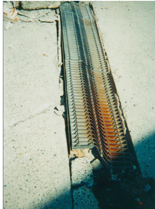
右：グレーチングは変形していた。
